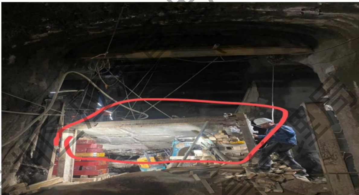
图三 塌落的仰拱板可见 22 工字钢（水平横撑、竖向支撑）等型钢组合结构
