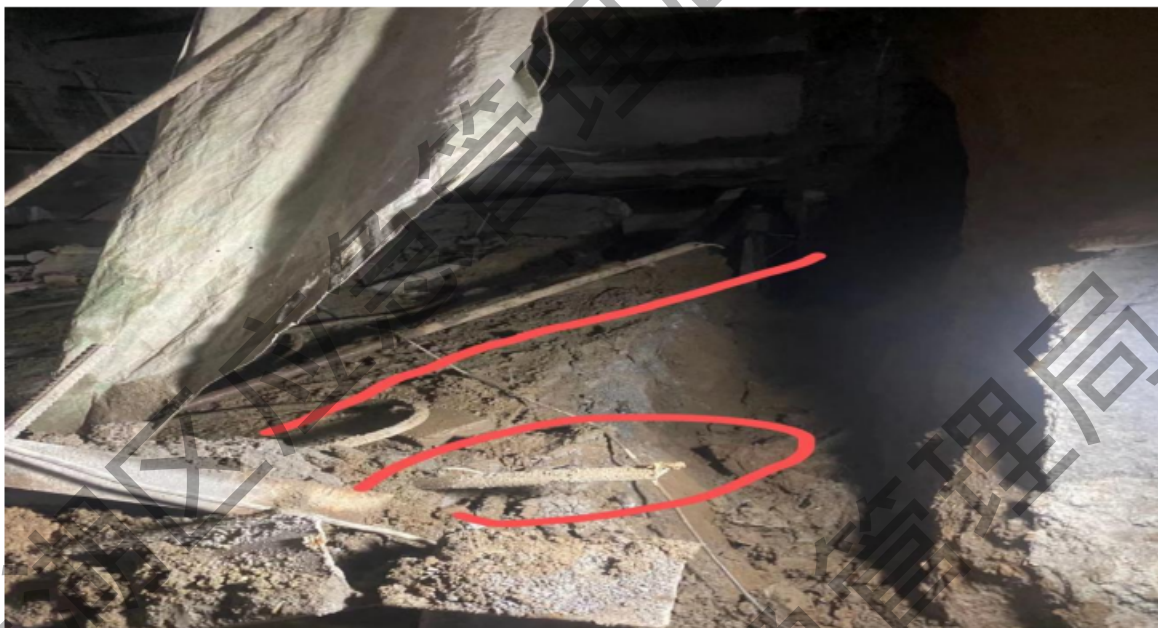
图五 塌方后掉落的锁脚锚管
