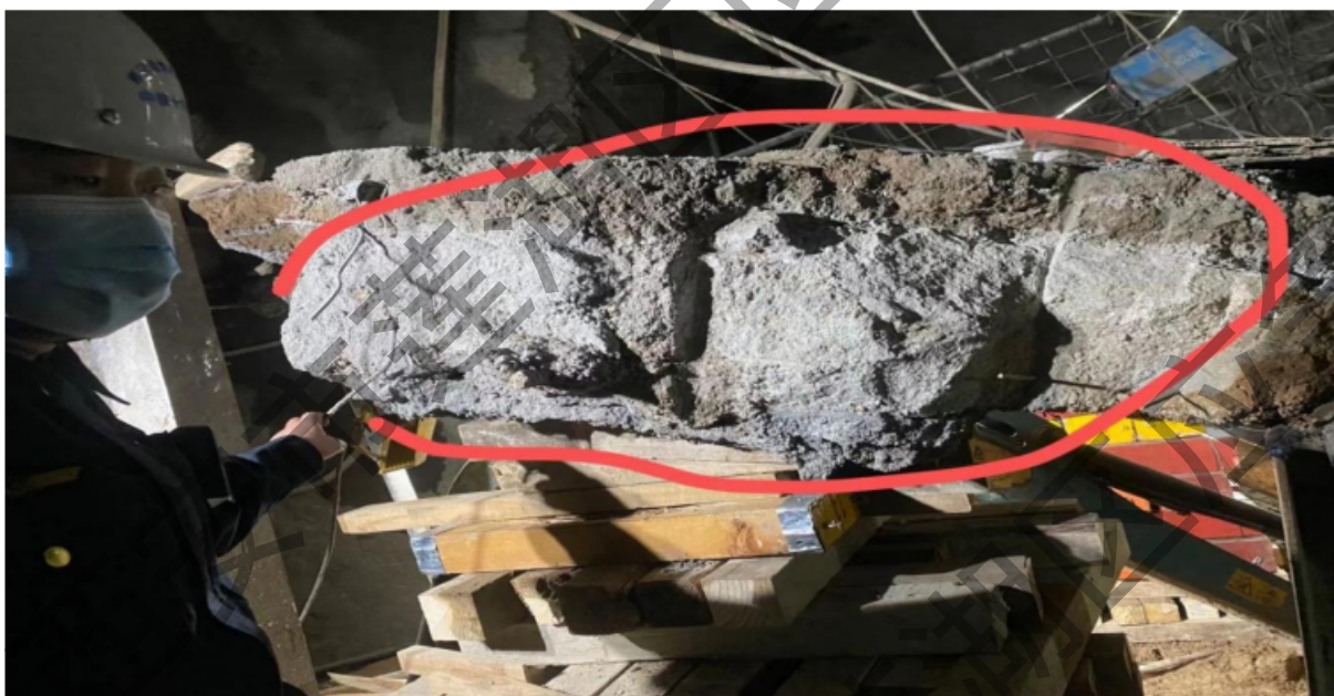
图四 坍塌临时仰拱喷射混凝土及残漏的钢筋网片
