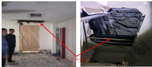
事故现场照片
